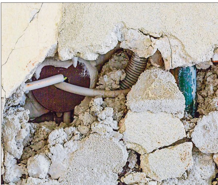
Bei der Abnahme von Bauleistungen, sollten Mängel sofort protokolliert werden.
