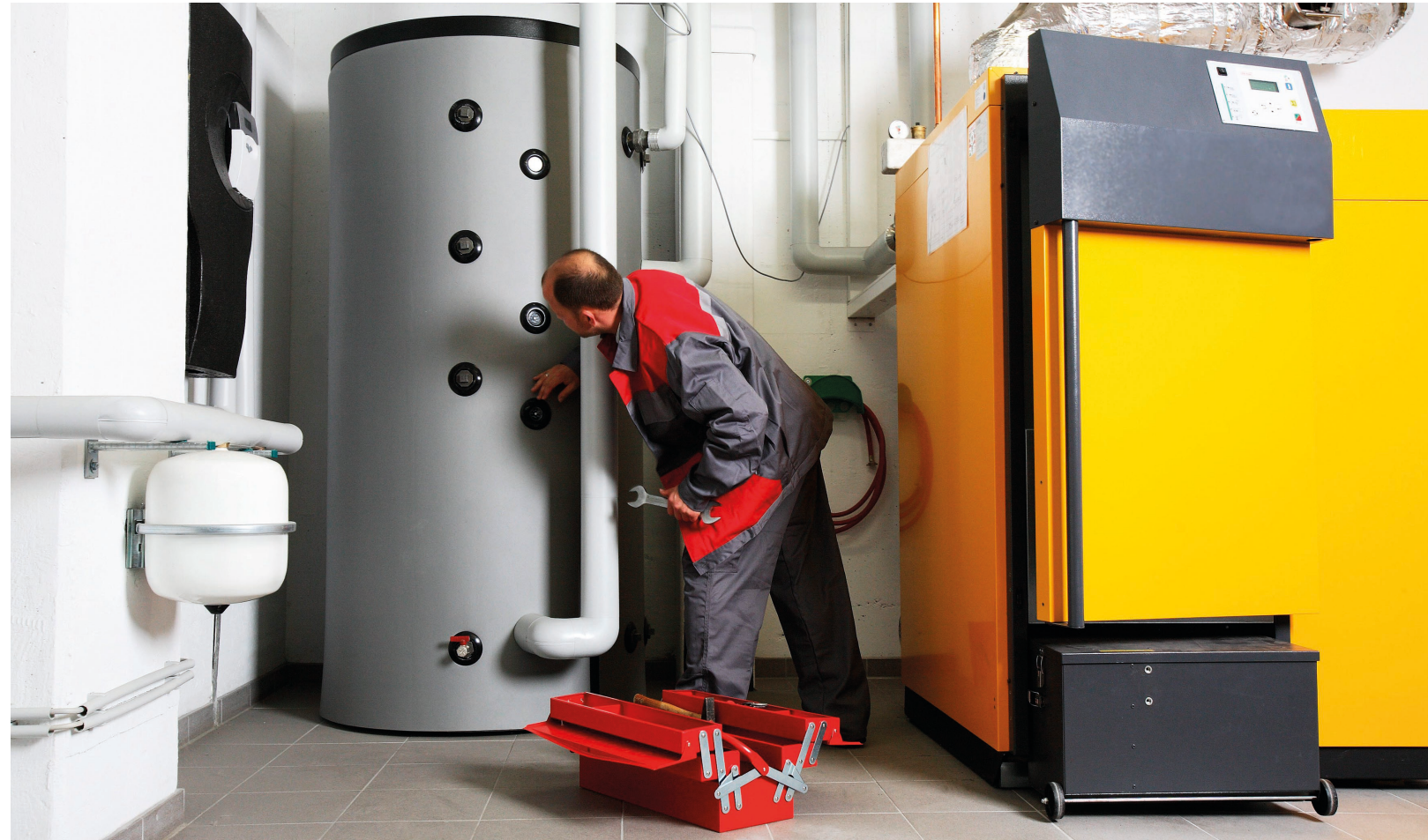
Die doppelte Vergabe eines Rahmenvertrags in Form einer Backup-Vergabe zur Wartung, Inspektion und Instandsetzung von Heizanlagen führte zu Streit. FOTO: DPA/CHROMORANGE
