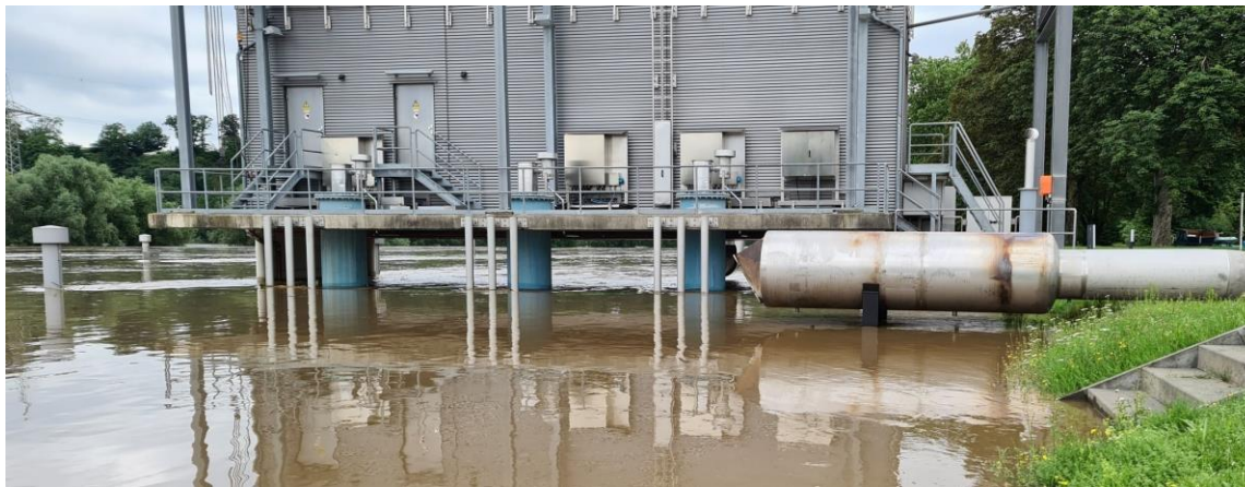
Oben: Hochdruckbehälter in Recklinghausen
