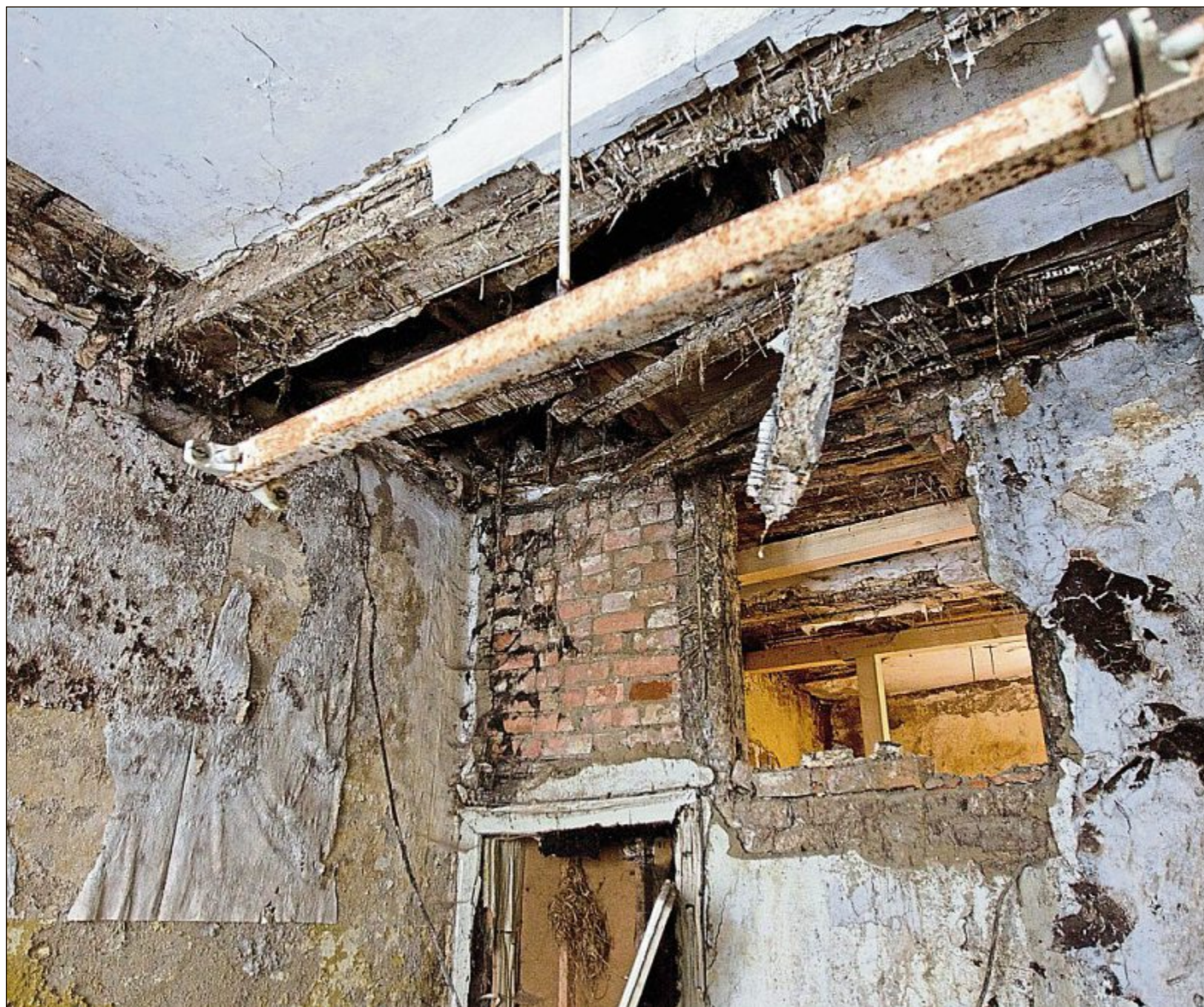
Um die Sanierung von Hausschwamm gab es Streit.
