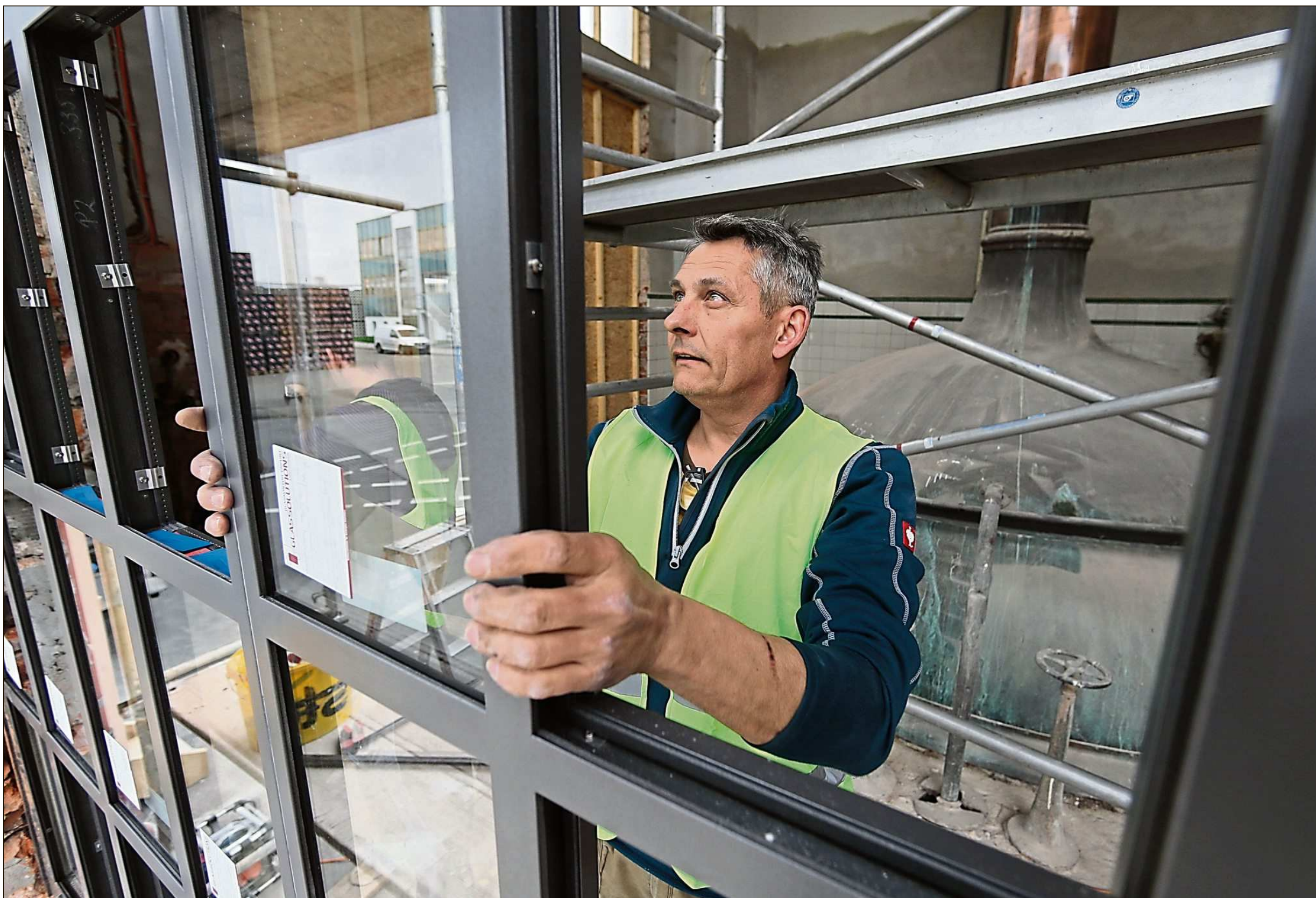
Bei der Ausschreibung von Fassaden- und Fensterarbeiten gab es Streit.
