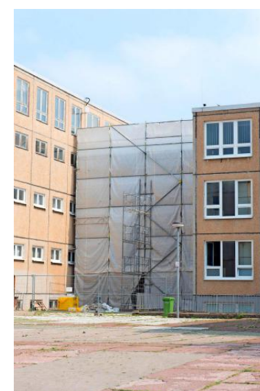
Die Sanierung einer Schule ist in einzelne Aufträge gesplittet worden. FOTO: DPA
