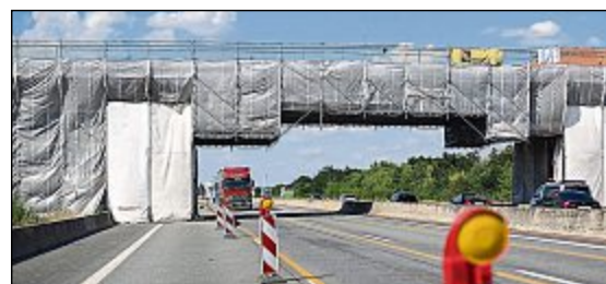
Brücken müssen wegen hoher Belastungen oft saniert werden.
