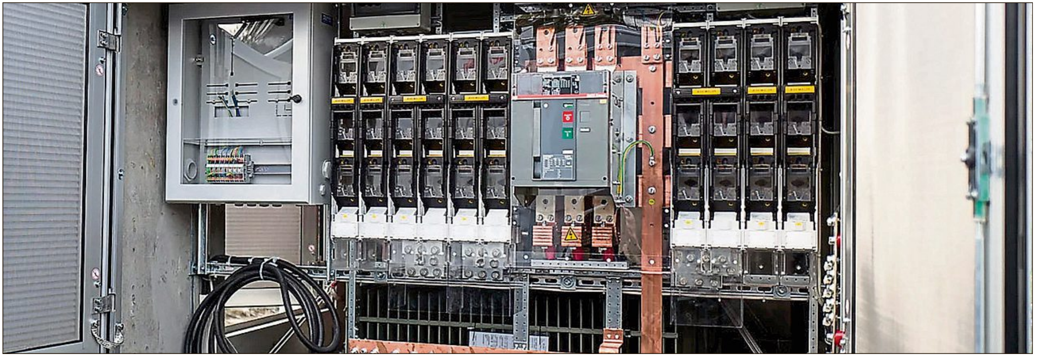
Um die Beschaffung einer Mittelspannungsanlage mit Trafo (Symbolbild) gab es Streit.
